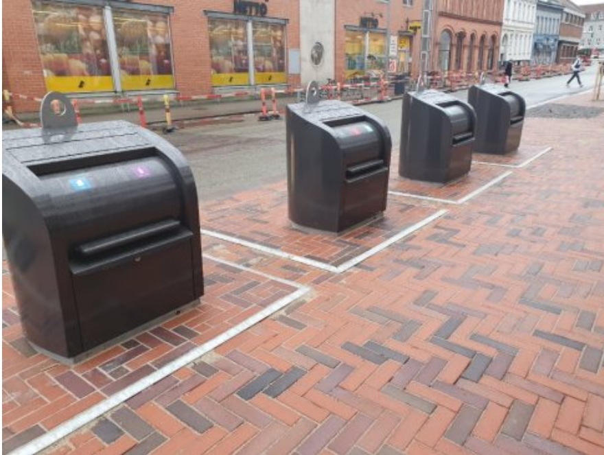
Nedgravet lÃ,snings i Jernbanegade 35
