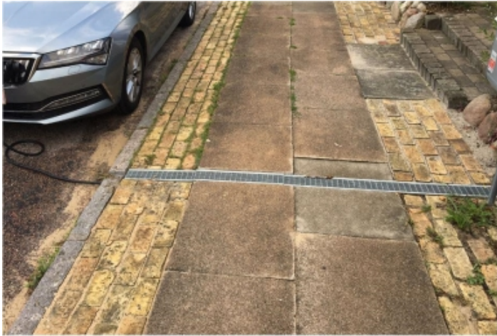
Figur 3 - Eksempel på kabelrende, fra Lyngby-Taarbæk Kommune
